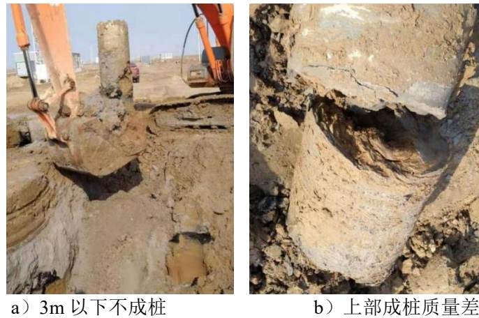
图 2 黄泛区常规浆喷桩成桩质量
